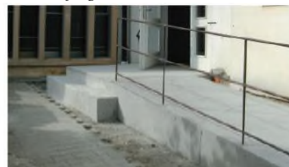
6.10.18 Die Rampe ist fertig betoniert, das neue Bronzegepländer eingepasst; am 13.10. wird die Oberfläche gestockt, damit sie einen guten Halt bietet.
